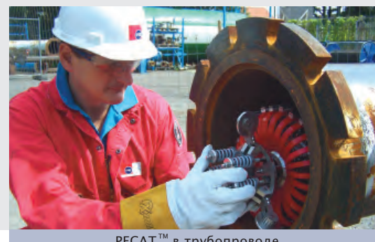
PE-CAT™ в трубопроводе
